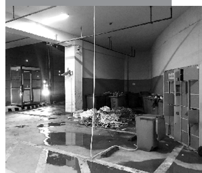
金佰汇广场地下停车库出入口,垃圾乱堆、脏水四溢、恶臭连连。
