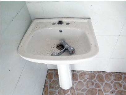
何田乡卫枫村十亩自然村村口公厕自来水龙头损坏未修。
