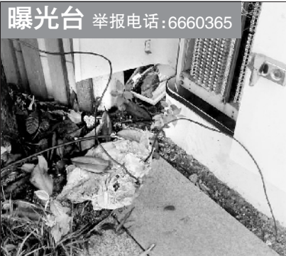
龙潭路口公交车站旁的配电箱破损。
